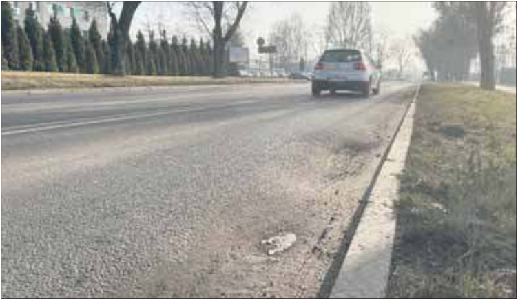
Koleiny w nawierzchni szczególnym utrudnieniem są w okresie zimowym
