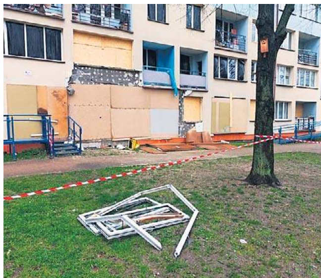
Między parterem a I piętrzem trzeba odbudować strop
