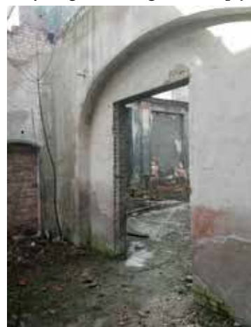
Wnętrze budynku wypełnia roślinność, sam obiekt grozi zawaleniem
