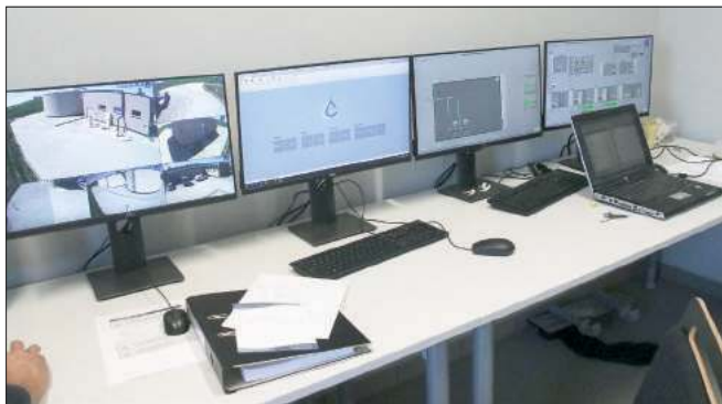
To „centrum dowodzenia” oczyszczalni
