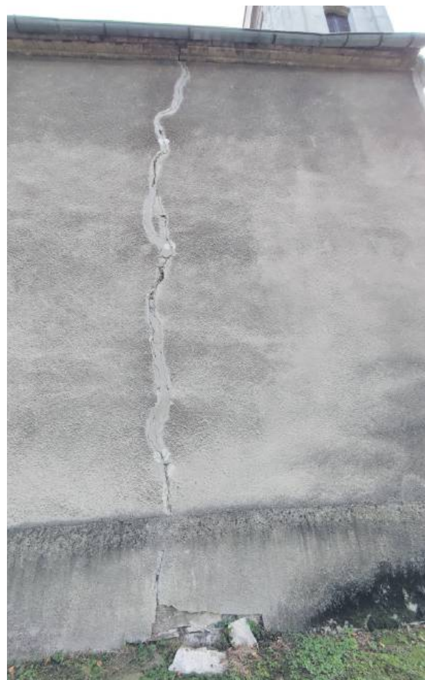
Na ścianach kościoła w kilku miejscach widoczne są duże pęknięcia
