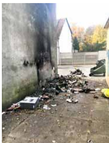
A to już krajobraz po podpaleniu i odymiona elewacja
