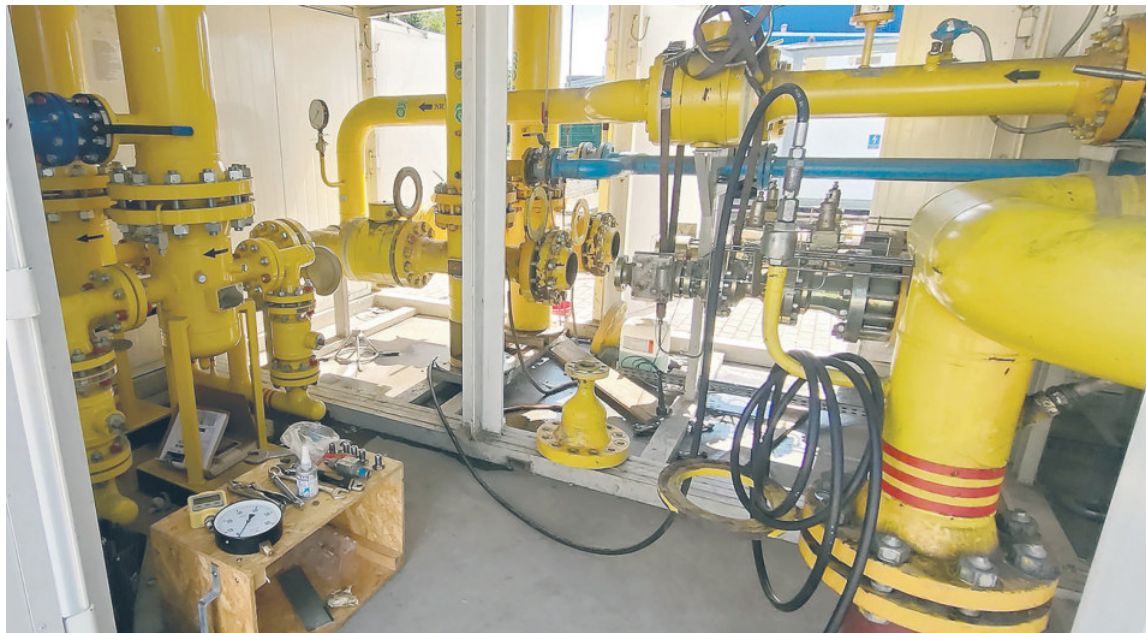
Modernizowana stacja redukcyjna gazu
