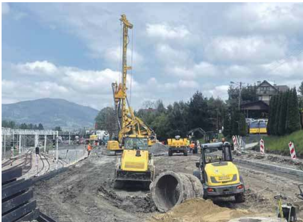
W obrębie osuwiska praca wre.
