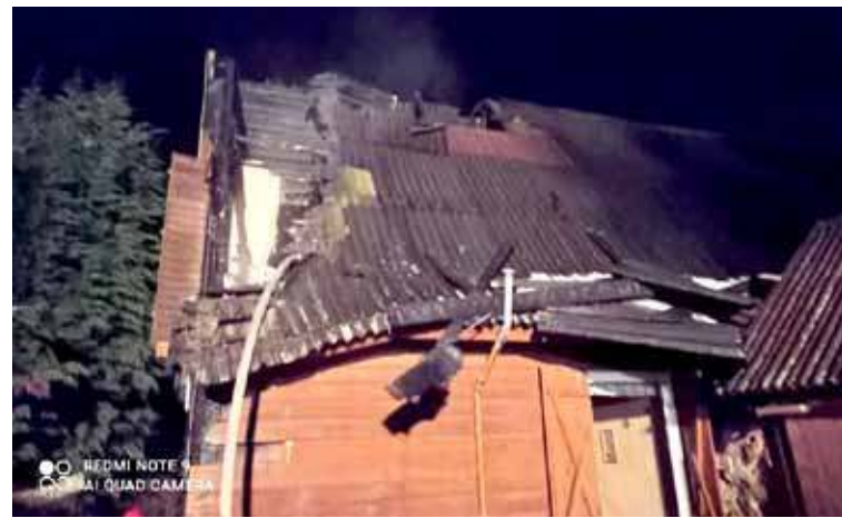
W wyniku pożaru spaleni uległo poddasze oraz piętro domku konstrukcji drewnianej. Foto. OSP. Stara Dąbrowa
