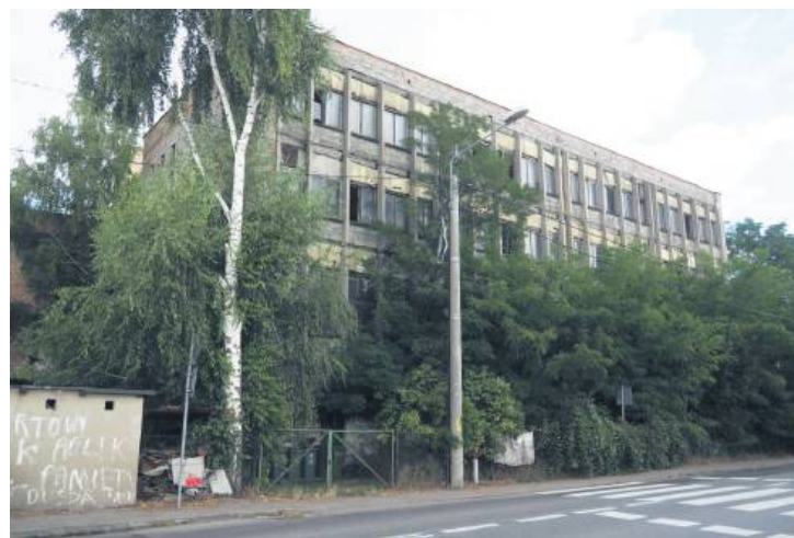
Już z zewnątrz widać, że budynek jest w fatalnym stanie i może stanowić zagrożenie
