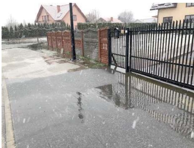
Brama wjazdowa i furtka prowadzące do posesji pana Eugeniusza są często zalane. Mężczyzna martwi się również o chodnik, na którym często stoi woda, a przy minusowych temperaturach robi się na nim ślizgawka
