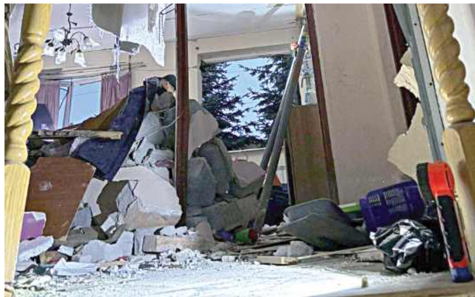
Siła wybuchu była tak duża, że część ściany szczytowej budynku uległa zawaleniu, a dom został poważnie uszkodzony
