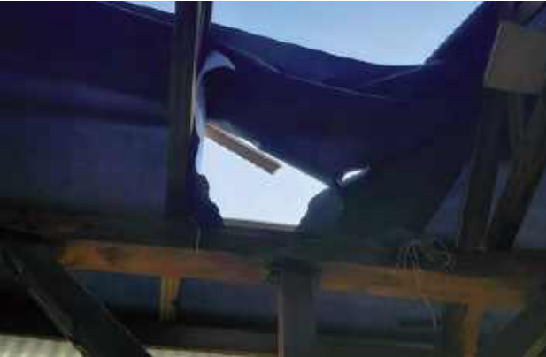
Mężczyzna, wymieniając pokrycie na dachu budynku, spadł z wysokości kilku metrów
