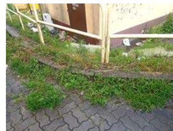
Chwasty są widoczne zwłaszcza w okolicach śmietników.
