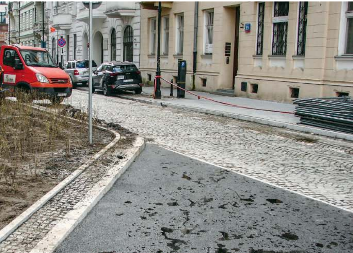
Niszczenie charakteru zabytkowej dzielnicy: przebudowany fragment ul. Poznańskiej | fot. Janusz Sujecki/Gazeta Polska
