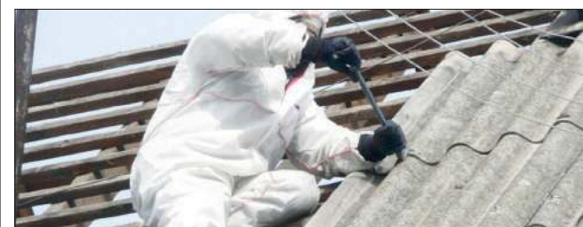
Azbest jest niemal wszędzie, ale w budownictwie jednorodzinnym najczęściej spotkamy go w formie pokrycia dachowego
