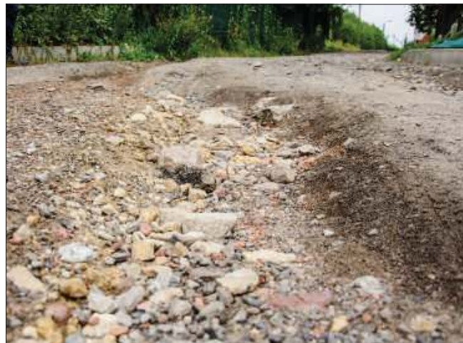
Prędkie nury wody, który w tym miejscu się pojawia, tworzy w ziemi głębokie żłobienia, które dla kierowców i pieszych są niebezpieczne.
