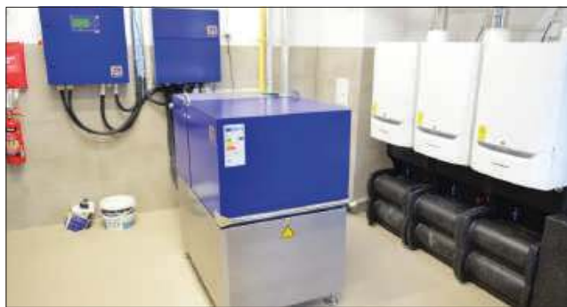
W kotłowni zainstalowano kogenerator, który produkuje energię elektryczną z gazu ziemnego.
