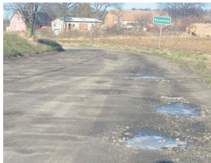
Stan drogi powiatowej w Kaczowicach pozostawia wiele do życzenia. Niebawem ma się to zmienić
