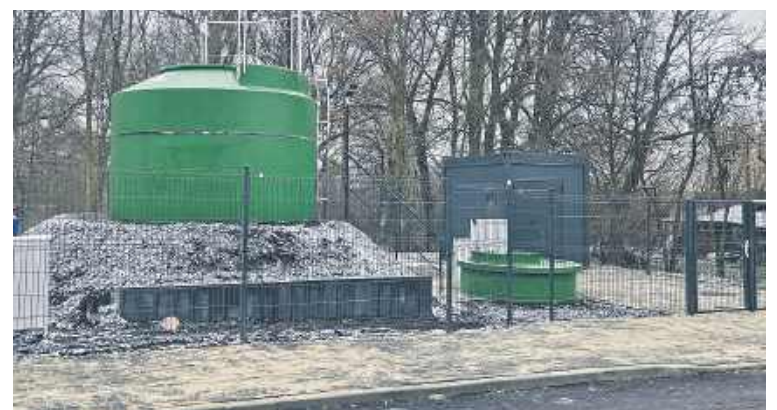
Oczyszczalnia ścieków w Brzezinach
