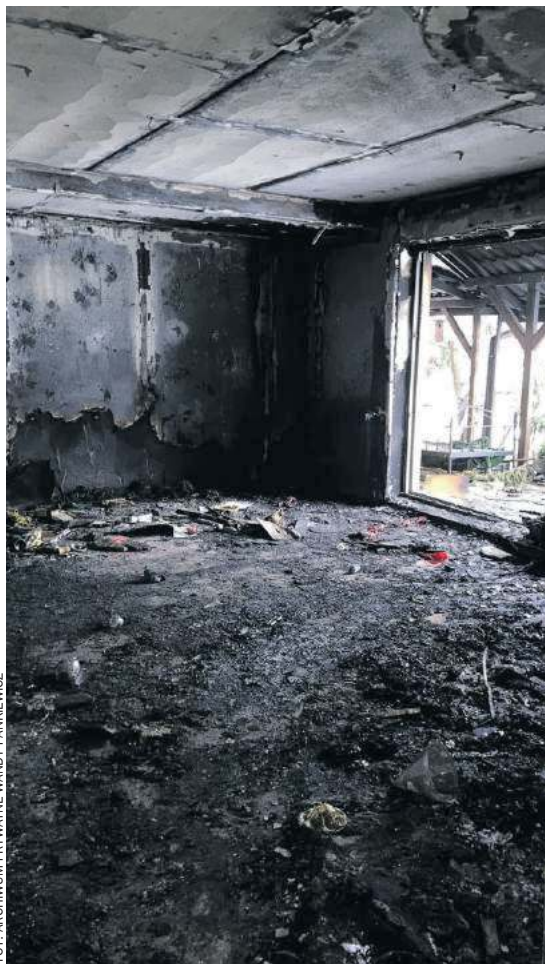
Remont spalonego domu wymaga bardzo dużego nakładu finansowego
