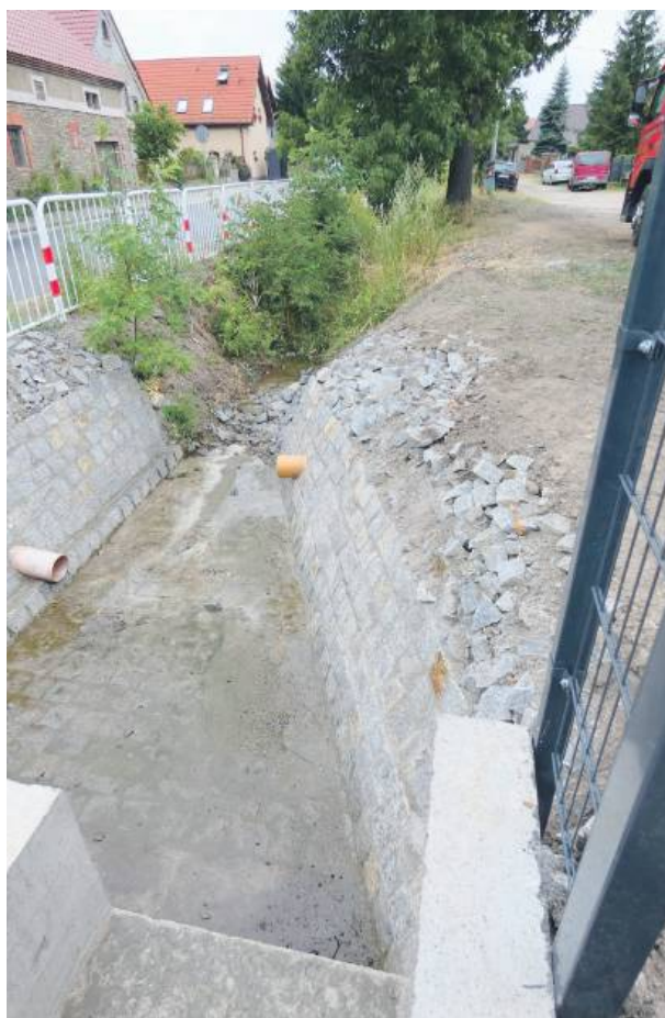
Tak wygląda odpływ z osadnika
