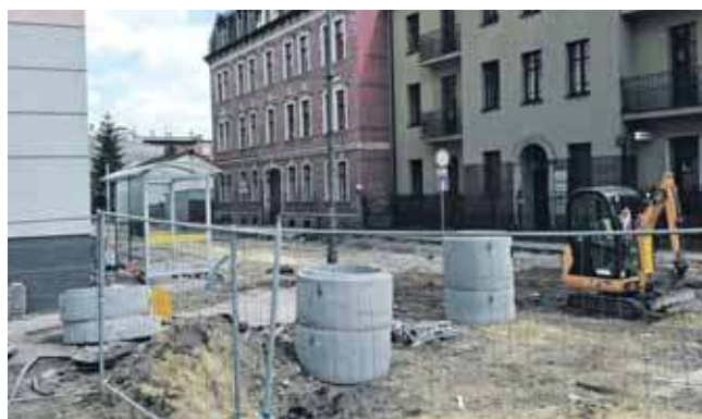
Koszty naprawy ewentualnych uszkodzeń wiaty ma pokryć wykonawca remontu ul. Powstańców Śl.
