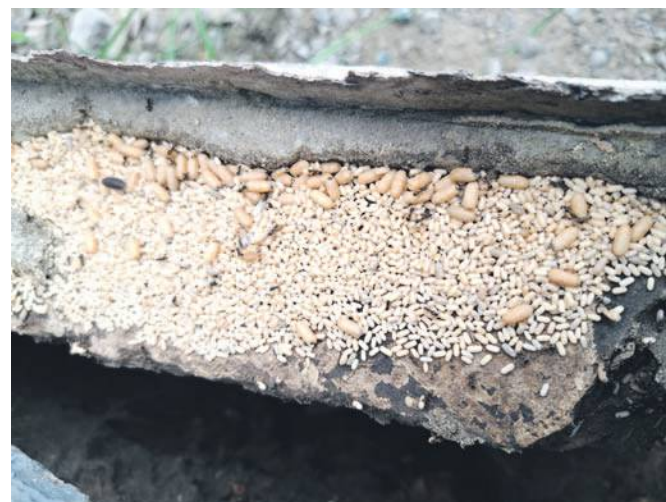
Taki był stan najniższej partii cokołu - w szczelinie było... ogromne mrowisko
