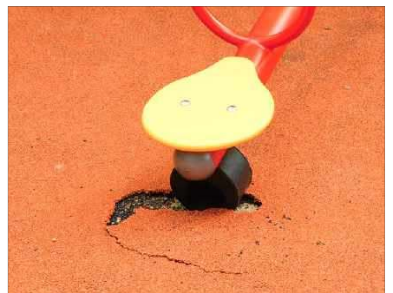
Nawierzchnia pod bujakami również wymaga naprawy.
