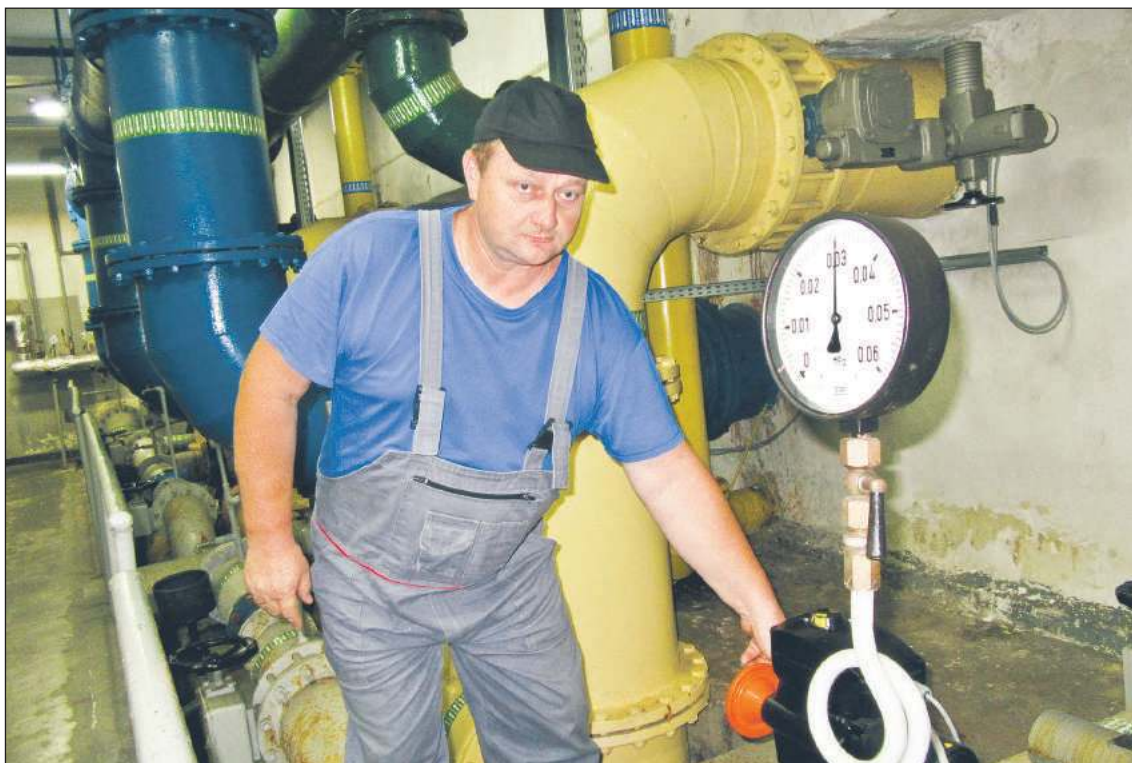
Jednym z pracowników Wodociągów Dębickich, który odpowiada za to, by na miasto wyszła woda o odpowiednich parametrach, jest Wiesław Florka, maszynista na Stacji Pomp Wodociągowych.
