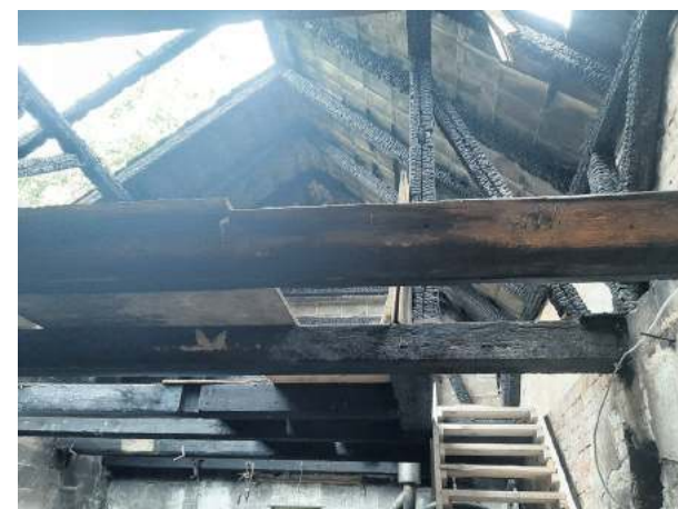
W tym pomieszczeniu znajdowały się kupione na kredyt meble i inne rzeczy potrzebne do remontu domu. Niestety, wszystko spłonęło...
