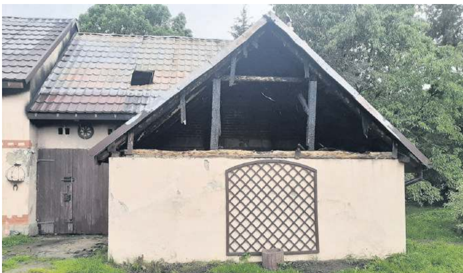
Na skutek pożaru uszkodzeniu uległ dach budynków gospodarczych, należących do rodziny. Jego naprawa jest niezwykle kosztowna
