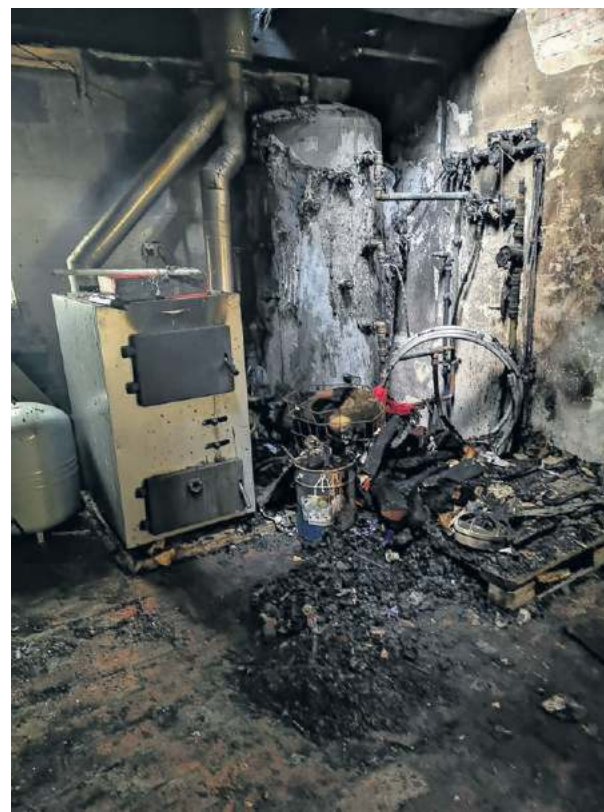
Ogień pojawił się w kotłowni, skąd szybko rozprzestrzenił się po całym budynku
