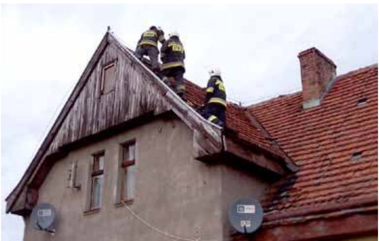
Strażacy z OSP Nowa Dąbrowa i Stara Dąbrowa usuwali dachówki, które po przejściu nawałnicy stanowiły zagrożenie. Foto. OSP Stara Dąbrowa
