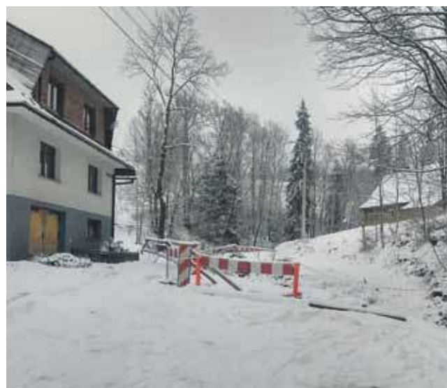
Z powodu remontu mostu 18 domów w Gliczarowie Dolnym zostało odciętych od świata.
