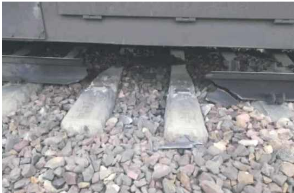
Wyrwa w torach miała ok. metra
