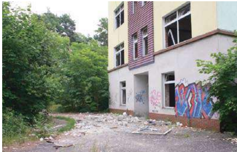
Po chwilowych nadziejach, że obiekt uda się doprowadzić do świetności, dziś jest na krawędzi ostatecznego upadku
