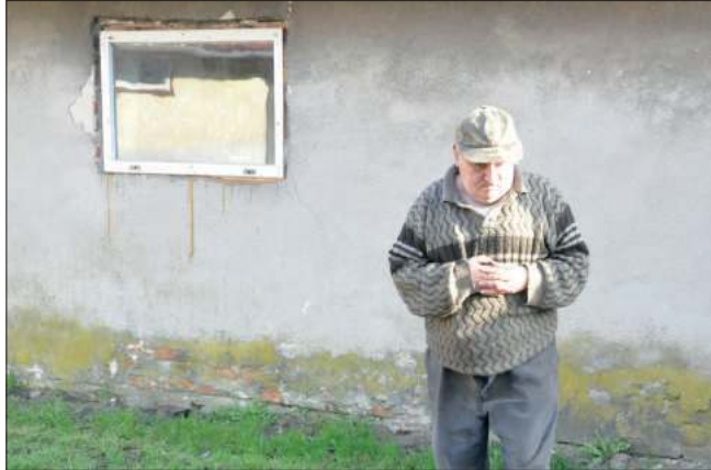
Nowe okna już są, teraz trzeba ratować resztę domu.
