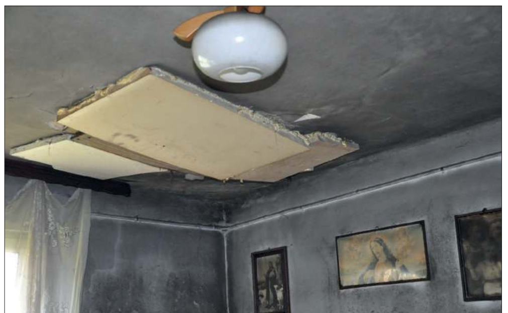
Sufit grozi zawaleniem.
