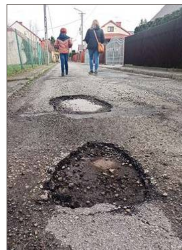
Takie ubytki to teraz norma.
