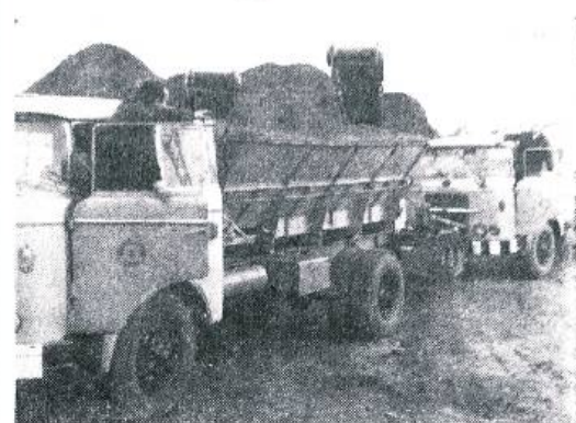
Taśmociągi pozwalają na sprawne ładowanie materiałów sypkich na samochody.
