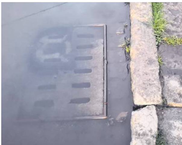
Z kratki kanalizacyjnej wybija „źródło” czarno-szarych ścieków
