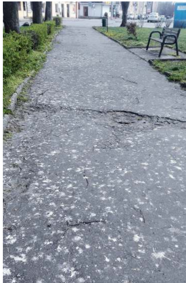
Chodnik również jest zabrudzony
