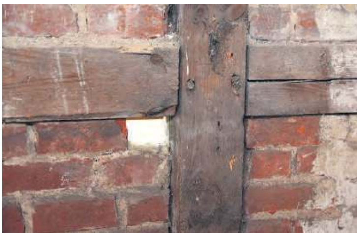
Stan budynku jest kiepski. W murze są ubytki, które zostaną uzupełnione.
