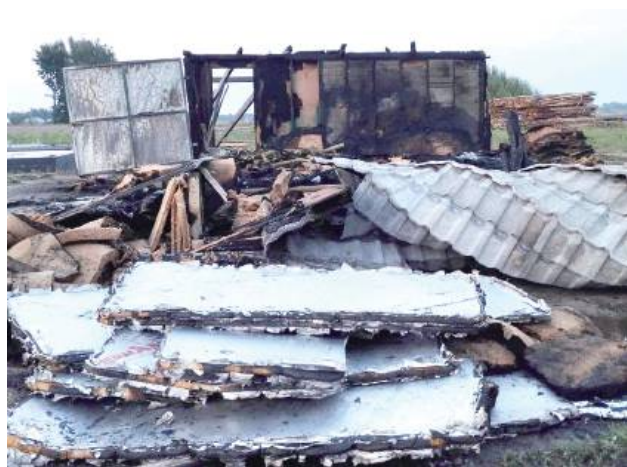
Pożar rozwinął się błyskawicznie. W garażu przechowywane było suche drewno na budowę domu, konstrukcja garażu również była drewniana
