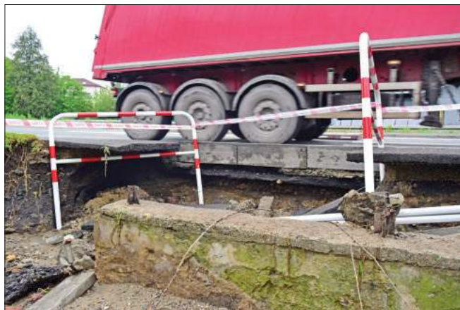
Uszkodzony chodnik przy ul. Bukowskiej w Syryni
