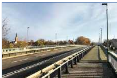
MOST WYSZYŃSKIEGO DO REMONTU \3
