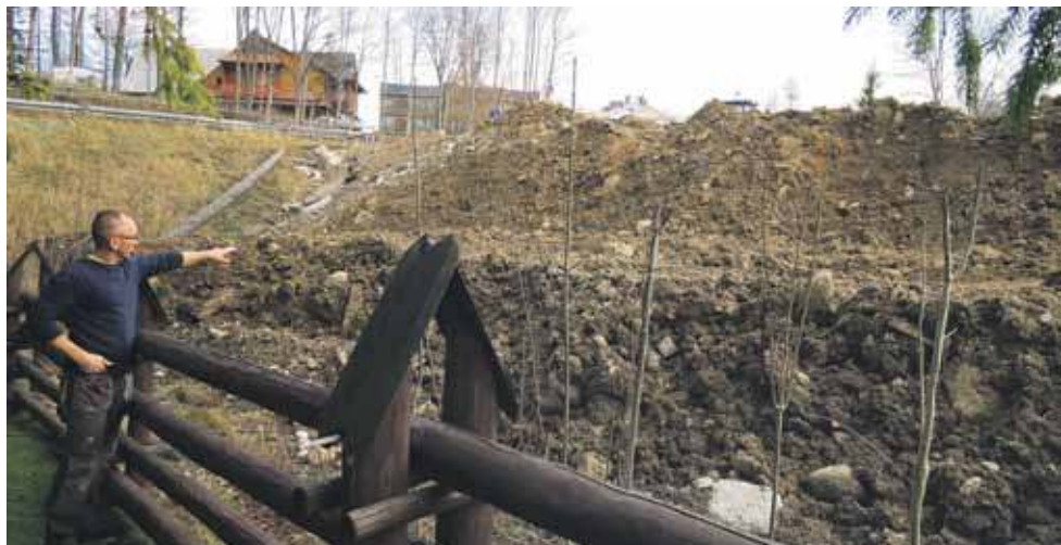
Przez weekend poziom gruntu na sąsiedniej działce podniósł się o kolejne półtora metra, a góra na wysokości asfaltowej drogi mierzy kilkanaście, jeśli nie kilkadziesiąt metrów.
