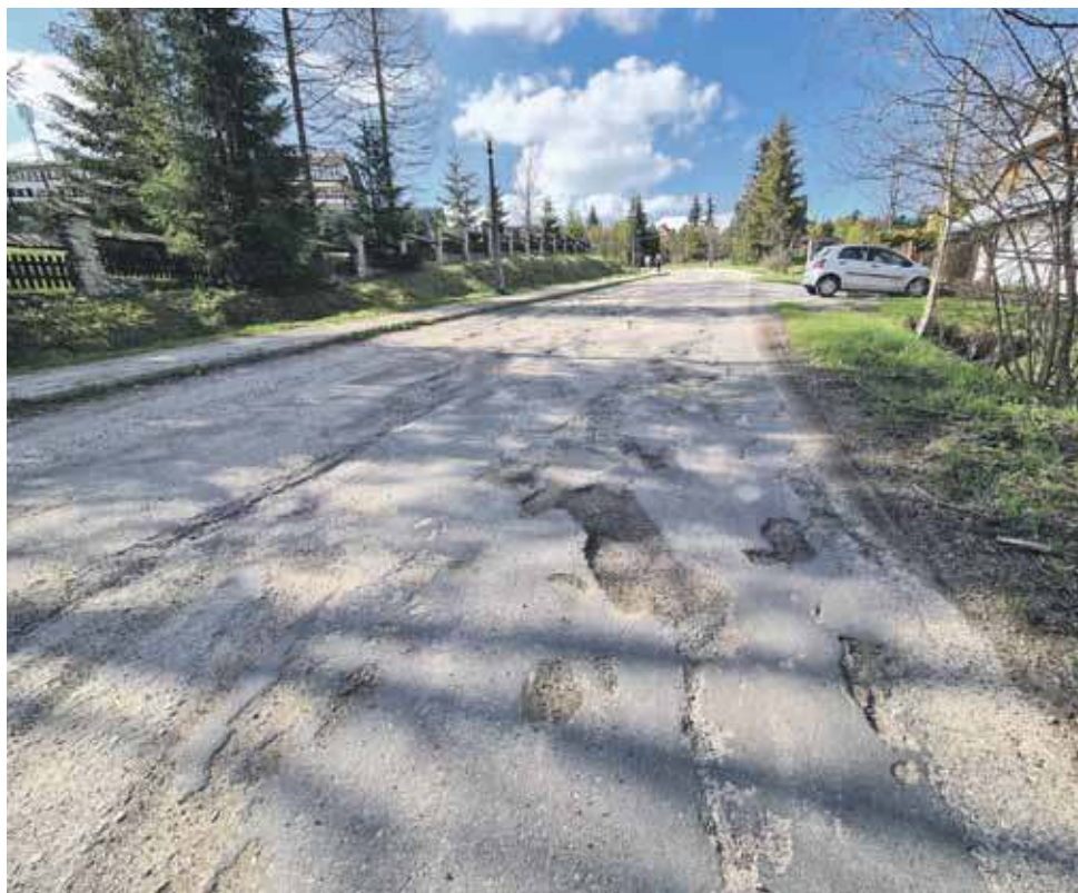
Sywarne - więcej tu dziur niż asfaltu.
