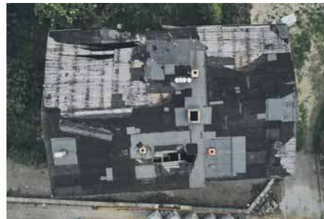
Dach zabytkowego budynku jest w fatalnym stanie
