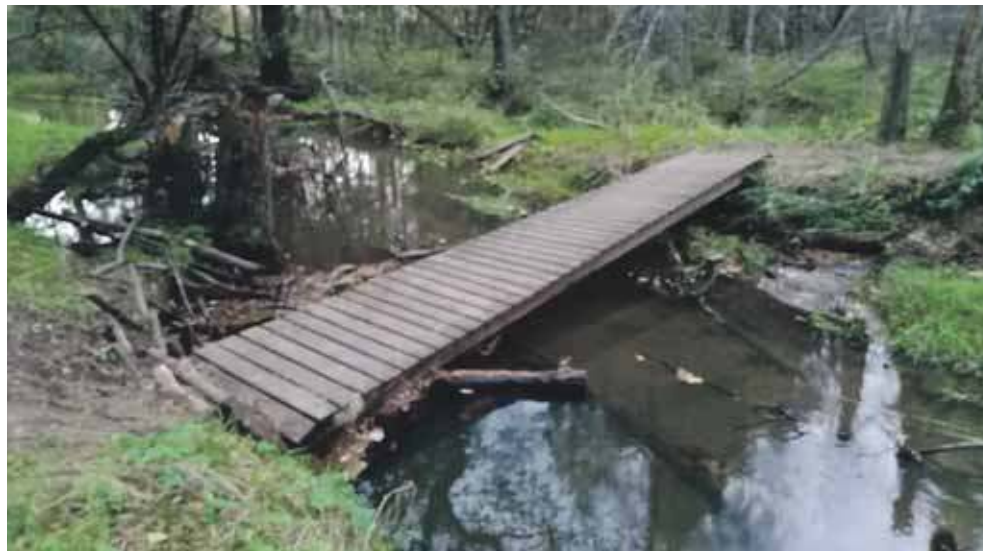
Kładka nad Małą Panwią jest, ale w świetle przepisów jej nie ma
