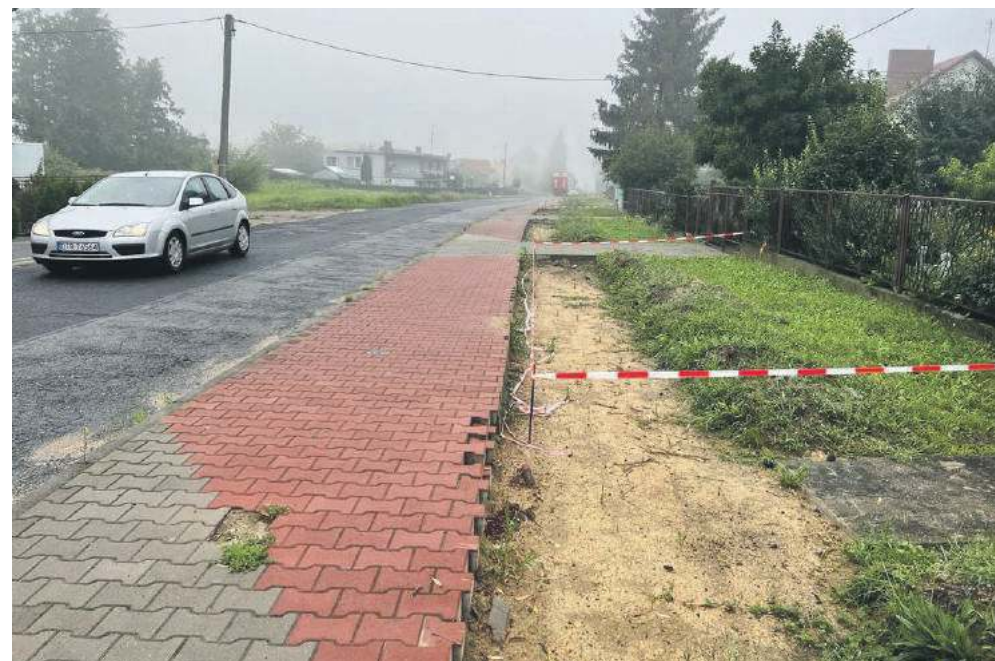
Nowy Dwór. Tak wygląda zabezpieczenie wykopów przy ścieżce rowerowej, a właściwie jego brak. Mieszkańcy nie pojmują co tu się dzieje?
