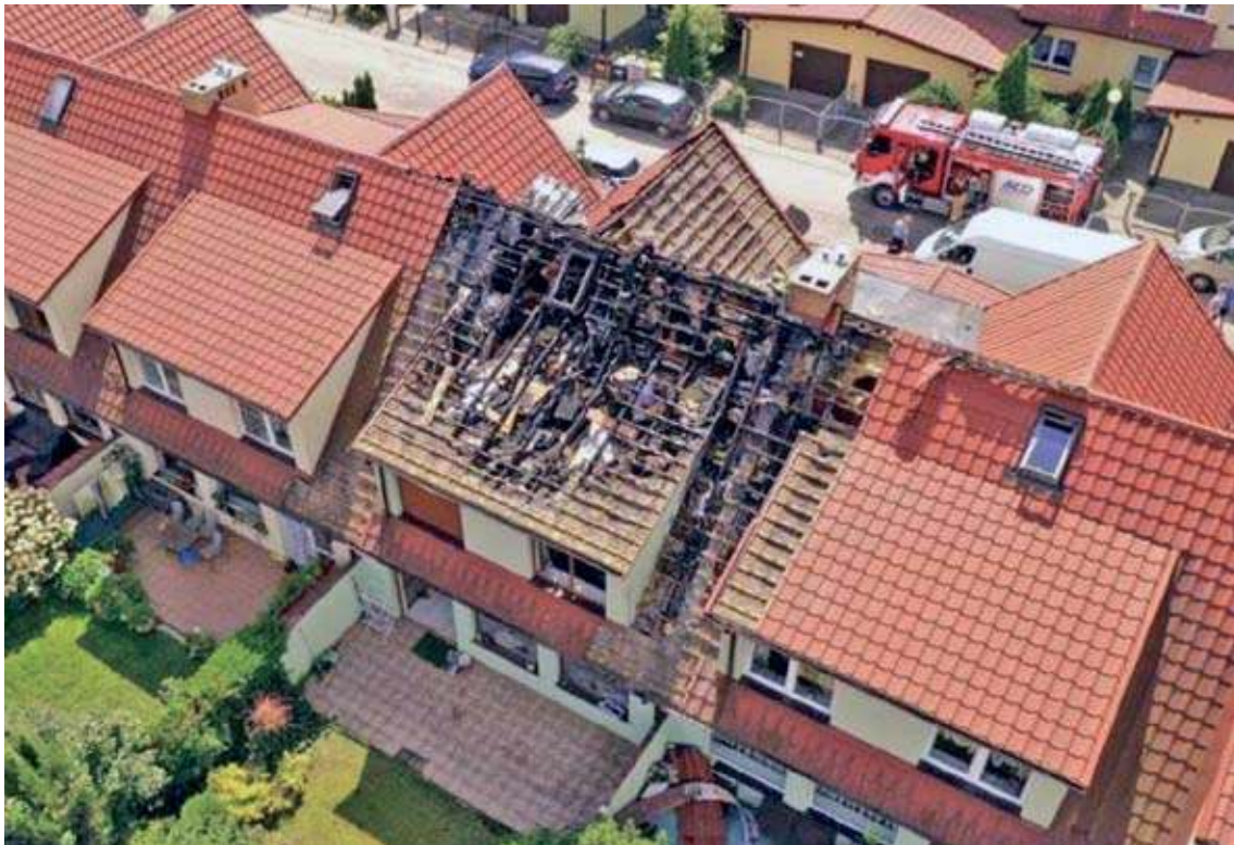
Dom wymaga gruntownego remontu (fot. zrzutka.pl)
