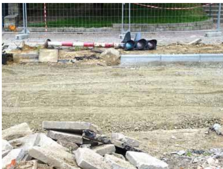
Stara sygnalizacja świetlna na Krasińskiego wycięta. Mamy nadzieję, że zamontują nową.
