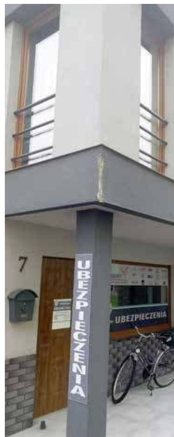
Obtarcie na części elewacji zostało dostrzeżone w poniedziałek wczesnym rankiem
