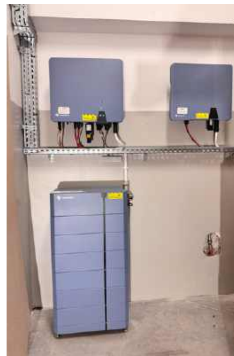
🔌 Magazyn energii dodany do istniejącej instalacji PV – bez wymiany falownika. INSTALATOR LEMONENERGY.PL
