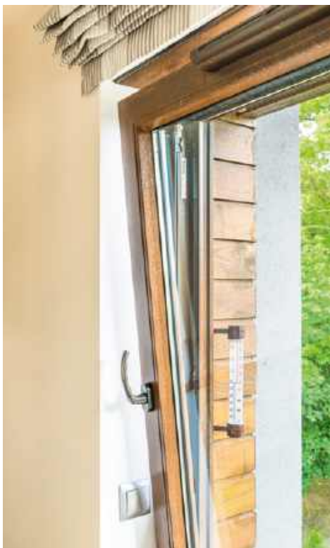
I Nowe domy są szczelne, więc niezbędnym elementem systemu wentylacji grawitacyjnej stały się w nich nawiewniki, montowane np. w górnej części okna. KRISHOME
