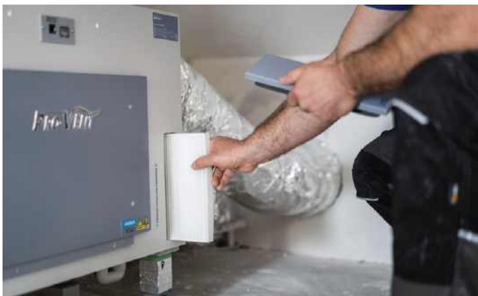
🔧 Filtry wymienia się co 3 do 6 miesięcy. Jeśli to zaniedbamy, wzrosną opory przepływu powietrza. PRO-VENT
