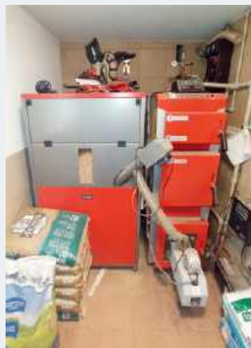
➤ W dużej kotłowni umieszczono kocioł n.p.s. i zapas peletów.
