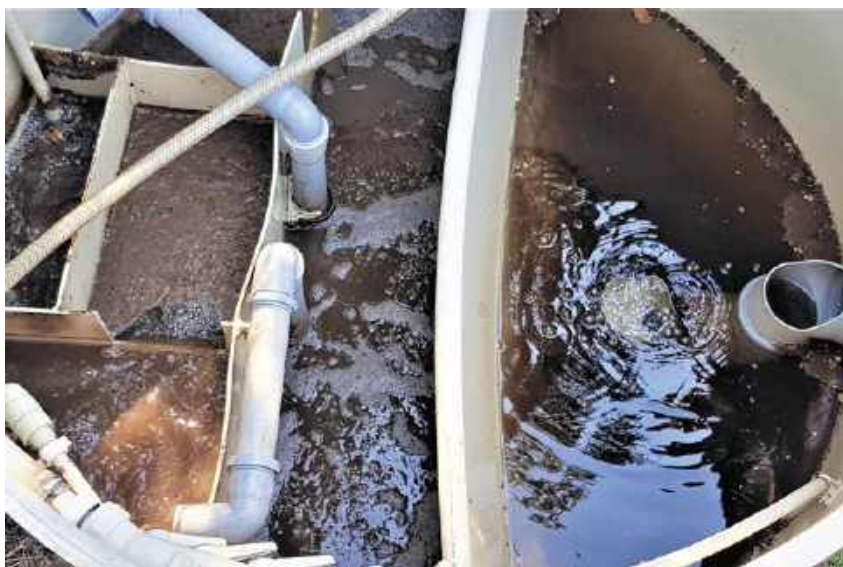
📍 Wnętrze oczyszczalni biologicznej. EKO HOUSE TECHNOLOGIE EKOLOGICZNE
