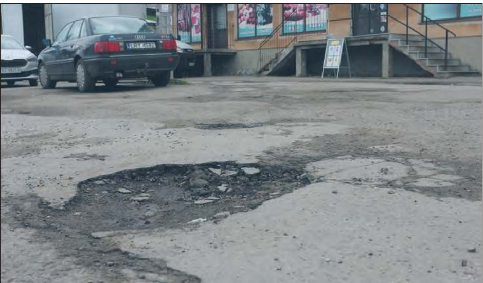
Wyraźne ubytki asfaltowej nawierzchni parkingu przed budynkami GS-u w Kłoczewie irytują kierowców. - Dlaczego nikt z tym nic nie robi - pyta jeden ze zmotoryzowanych
