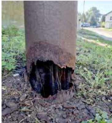
W tym miejscu, u swej nasady, słup jest zniszczony rdzą
